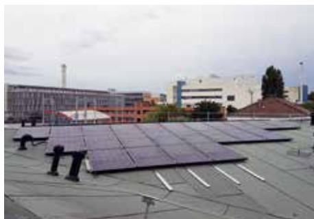
DACH MIT SOLARANLAGE
